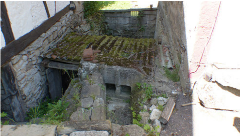
Der Einlauf auf das überschlächtige Eisenrad
