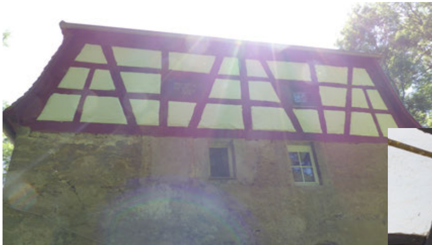
Rückseite des Mühlengebäudes mit teilweise freigelegtem Fachwerk. Die Freilegung des unteren Teiles würde einen zu hohen Eingriff in die historische Bausubstanz bedeuten, da der aufgebrachte Zementputz mit dem Untergrund verbunden ist.
