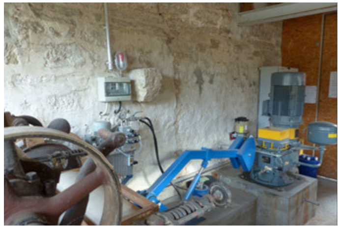
Stromerzeugung in der Weißenmühle
