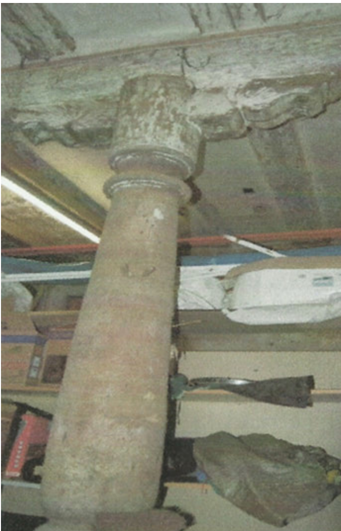
Mühlsäule im Mühlraum der Schmelzmühle Foto: Anna Wirth
